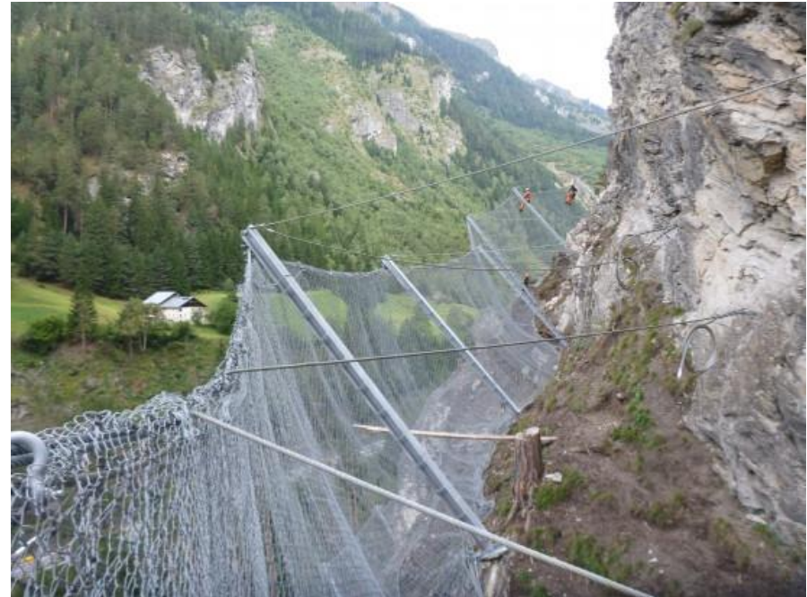
Senzori za praćenje padinskih procesa postavljeni su na krajeve metalnih držača zaštitne mreže.
